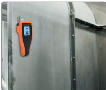
Monitorización remota de los parámetros climáticos
